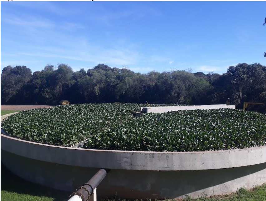
Figura 2 – Macrófitas implantadas no filtro anaeróbio
