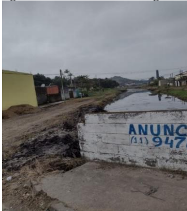
Figura 11– Ruas sem drenagens de águas pluviais
