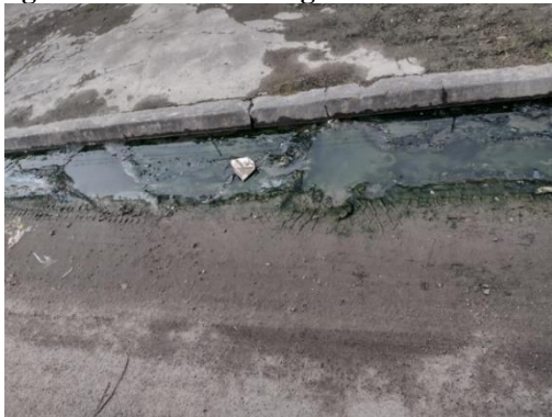
Figura 12 – Ruas com esgoto a céu aberto
