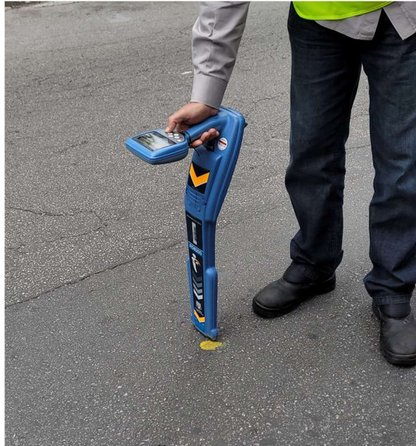
Figura 7 – Execução do caminhamento sobre a rede.
