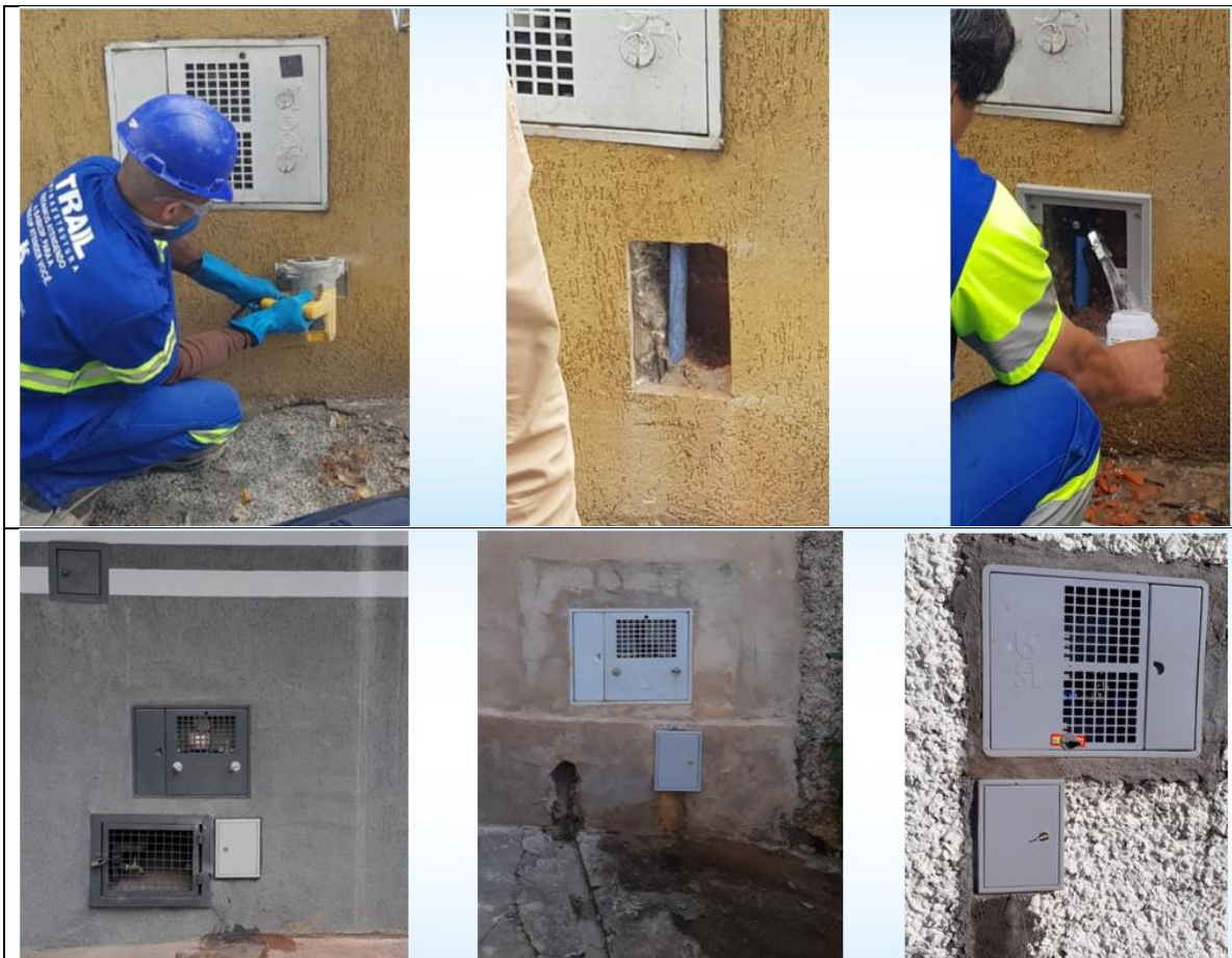
Figura 5 – Fotografias da instalação e de algumas UCQAs instaladas.
