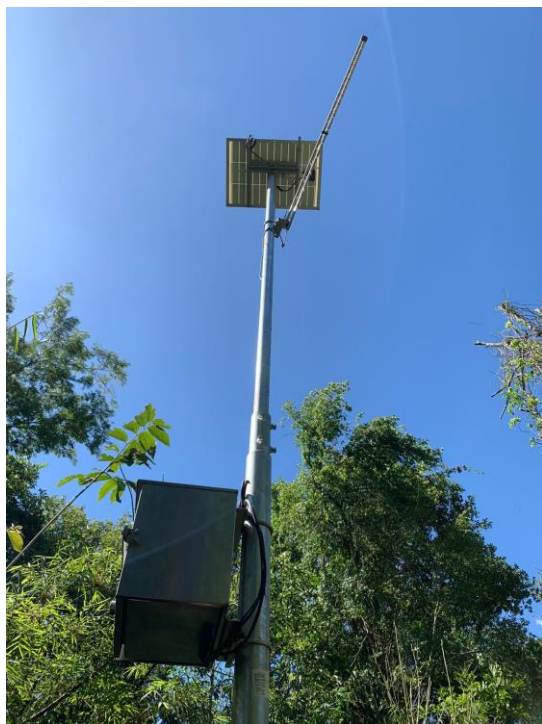
Figura 3c - Quadro de Controle e Automação, alimentação Fotovoltaica.
