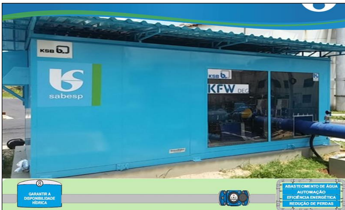
Figura 18: BFT passa a ser operada pelo Centro de Controle Operacional CCO) (fonte: Sabesp-2019)
