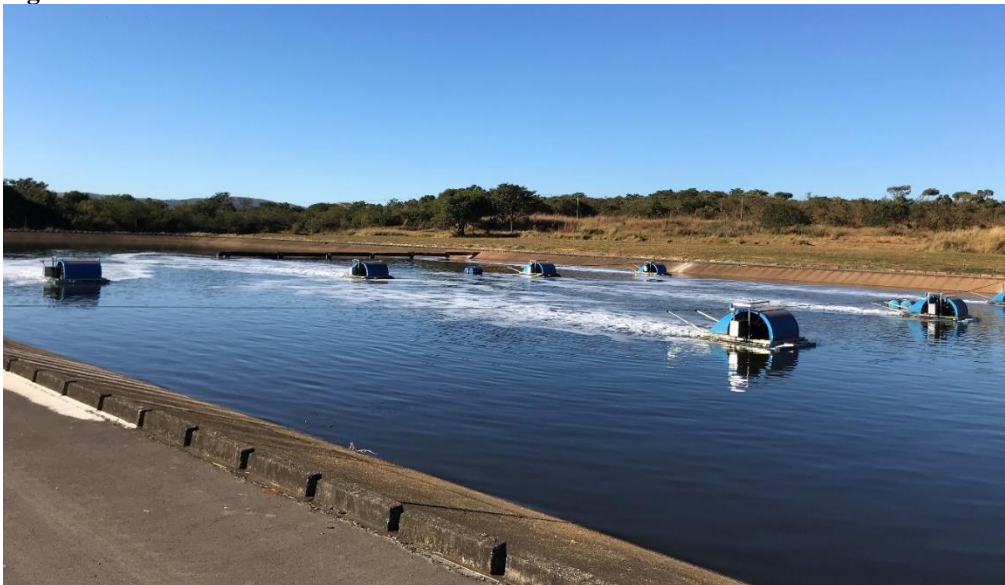
Figura 4 – Aeradores cachoeira instalados
