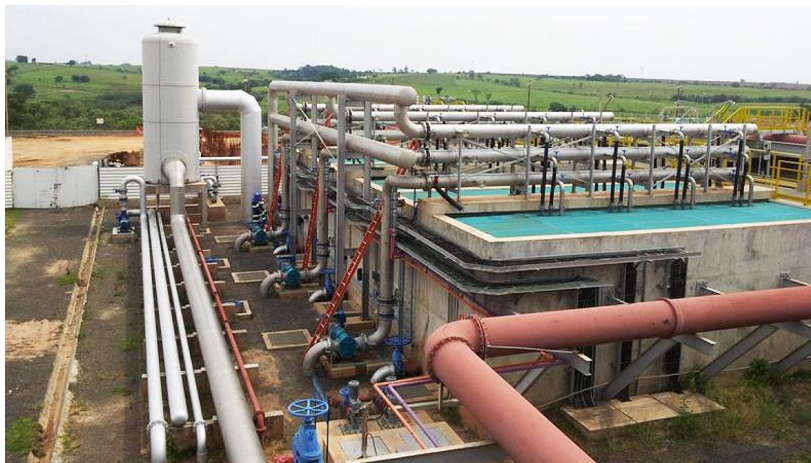
Figura 3 – Visão dos três trens de membrana na planta EPAR Capivari II.
