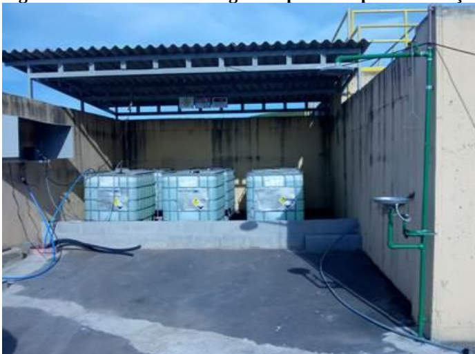
Figura 5 – Estrutura de dosagem implantada para realização do teste na ETA
