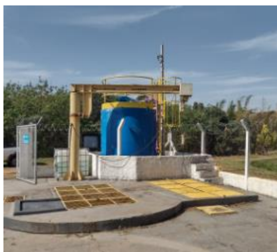
Foto 2: Sistema de dosagem de cal magnesiana
