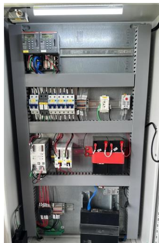
Figura 6: Painel do CCO da ETE Bonsucesso.
