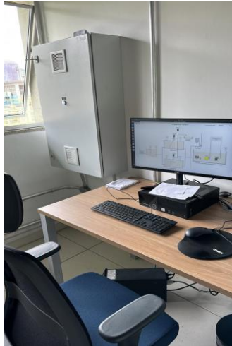
Figura 5: Painel do CCO da ETE Bonsucesso.
